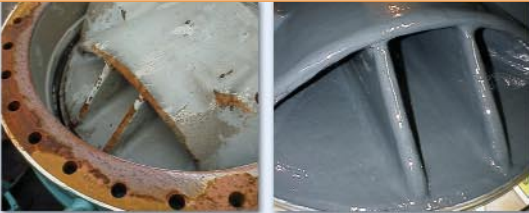
A korrodált pillangószelep – felújítás előtt és után
